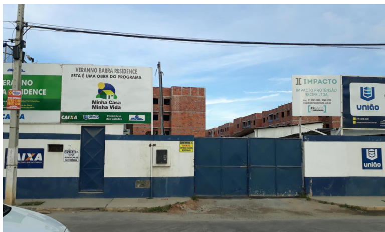
Figura 19: Condomínios de apartamentos sendo construídos pelo PMCMV na cidade da Barra dos Coqueiros na RMA.
